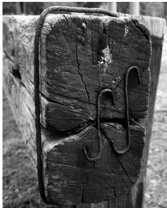
Figura 12. Sistema para prevenir el agrietamiento transversal debido a la liberación de tensiones de crecimiento, mediante el uso de grapas metálicas. Foto: G. Vargas.
